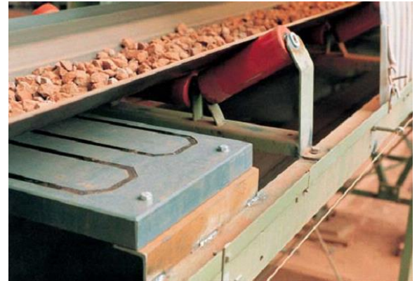
Metalldetektor QLC als Einzelsonde unter dem Förderband montiert.
